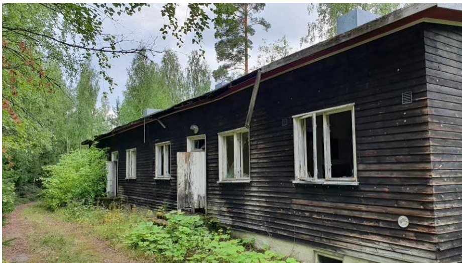
Kuva 15 Märjälahdentien itäpuolella oleva huonokuntoinen parakki Alueella on Lieksan eteläpään vesiosuuskunnan vesi- ja viemärijärjestelmä.
